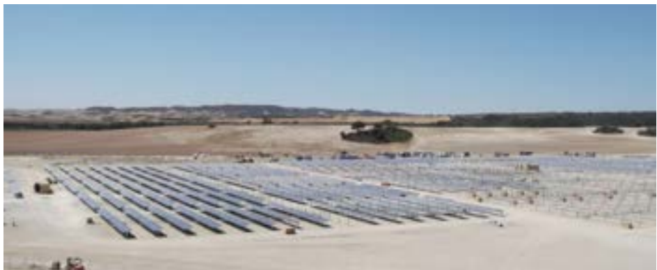
Zuera 11 MW, Zaragoza
